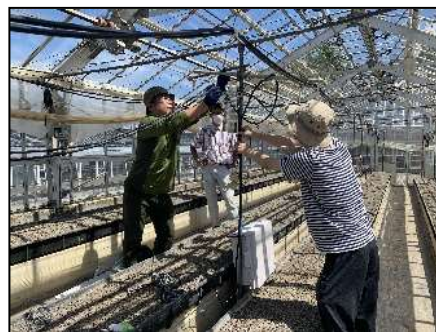
図6 幡多農業高校メロンハウスに設置
